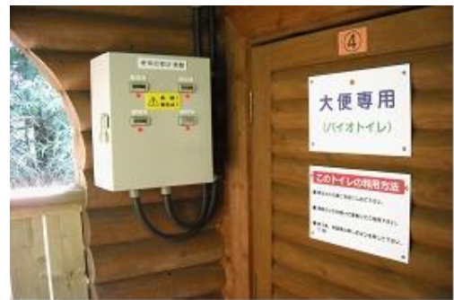
扉注意事項表示
