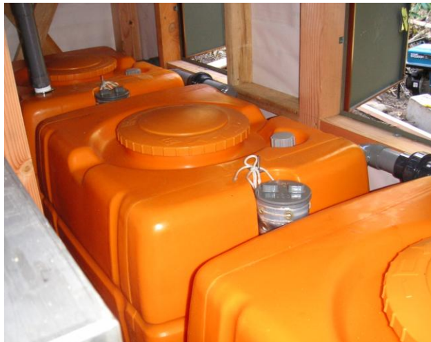
し尿分離用の尿タンク
