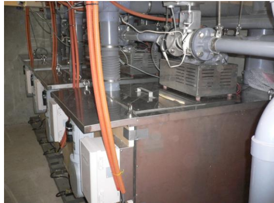
ピット内のバイオトイレ
