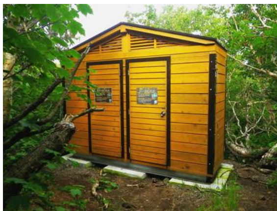
（写真１９）固定式トイレブース２基
