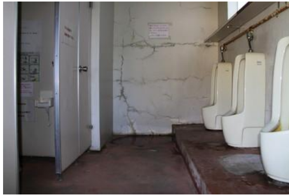
(写真3) 望岳台トイレ・壁のひび割れ
