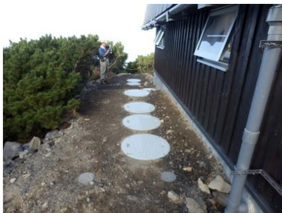
(写真-3) 土壌処理トイレのマンホール群
