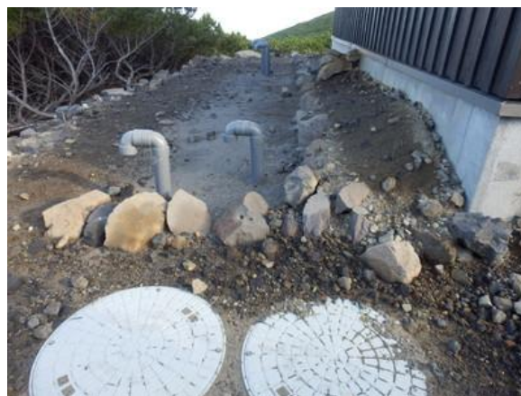
(写真-4) 土壌処理装置の通気管
