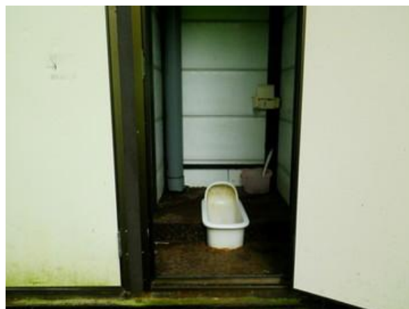
(写真 1 2) 簡易トイレの中
