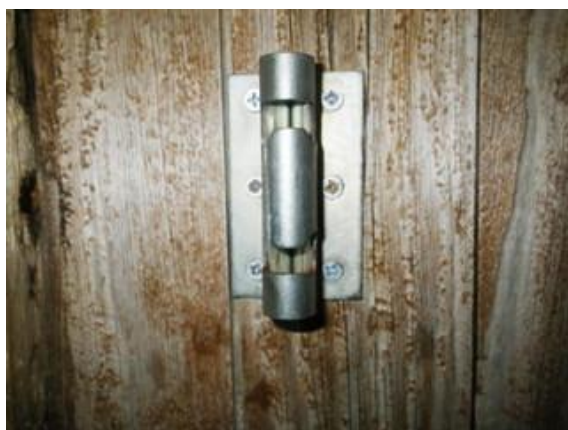
（写真４０）トイレ内の錠は破損
