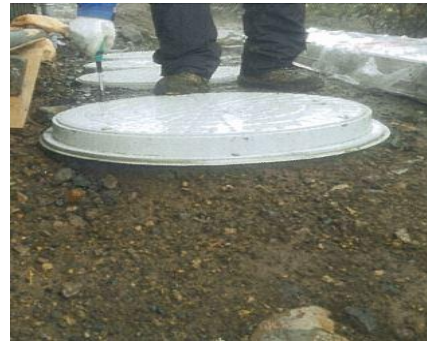
●写真5 マンホール周辺の侵食状況
