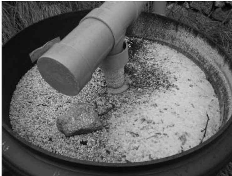
芙蓉パーライト製 尿処理装置の表面
