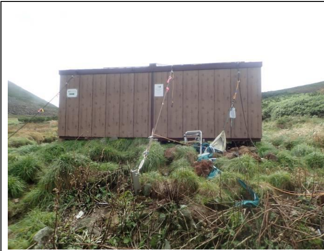
仮設トイレ倒壊
