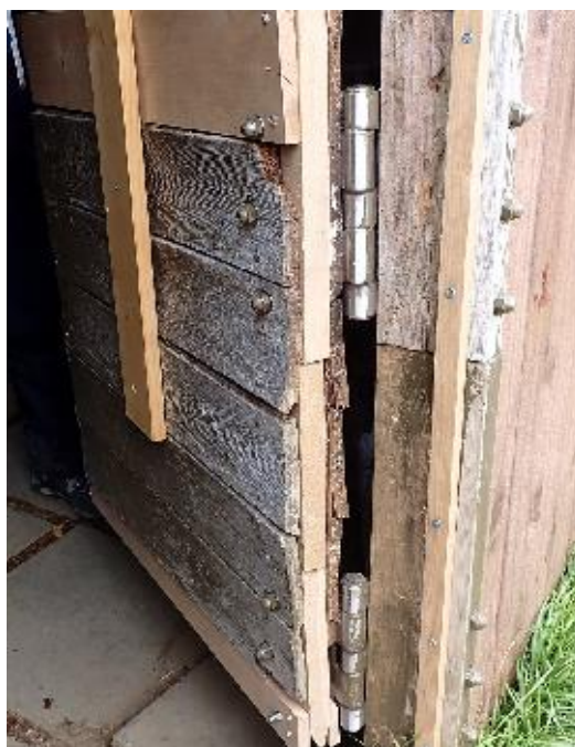
応急処置された避難小屋ドア
