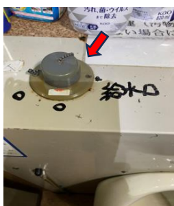
簡易水洗用 水タンク給水口 (プレハブトイレ側)
