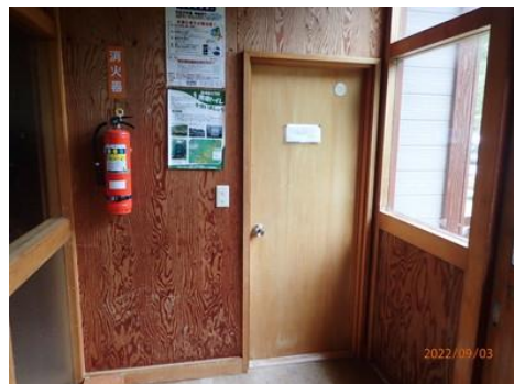
トイレ室のドア
