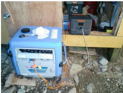
可搬型発電機とポータブル電源
