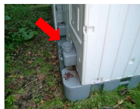
簡易水洗の水注入口
