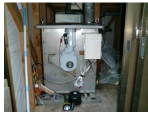
バイオトイレの装置
