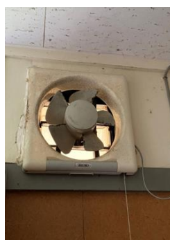
トイレルーム上部壁の換気扇
