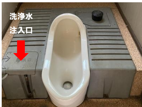
プレハブトイレの和式便器 右前の黒いペダルを踏むと洗浄水が出る
