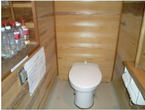
幌尻山荘バイオトイレ（別棟）
