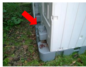
簡易水洗の水注入口
