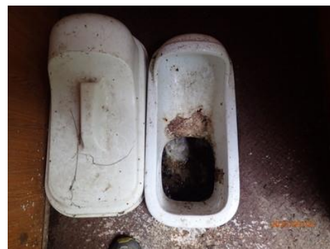
便器は汚れ、便槽は満杯
