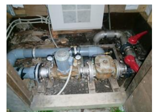
水力発電装置
