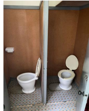
洋式便器は2箇所
