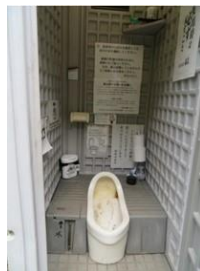
仮設トイレ内部 簡易水洗
