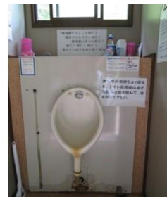
プレハブトイレ内部 (小便器) 排尿後は右下のペダルを踏むと水が流れる
