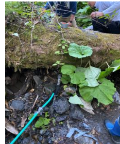
取水源から山荘へ伸びるパイプ
