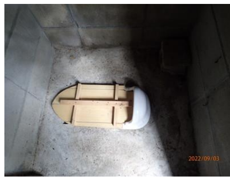
和式トイレは携帯トイレブース室
