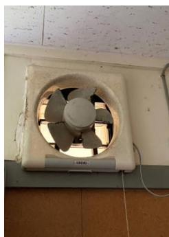
トイレルーム上部壁の換気扇
