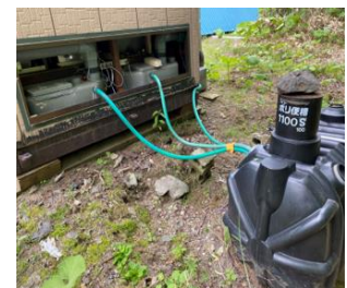
便槽で固液分離され、汚水は綠色ホースで右側黒色の貯留タンクへ流れるしくみ
