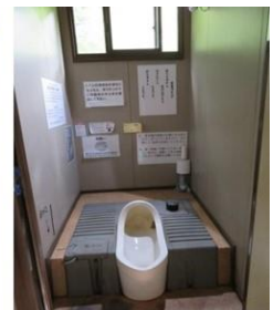
プレハブトイレ内部 (和式側) 排泄後は右上の凸部を踏むと水が流れる
