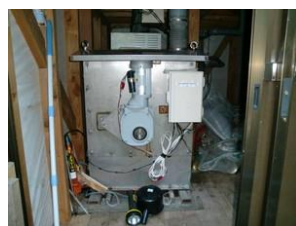
バイオトイレの装置
