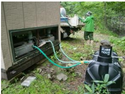
便槽の汚水を黒いタンクに貯留する
