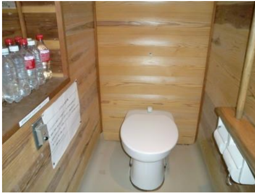
バイオトイレ（洋式便器）
