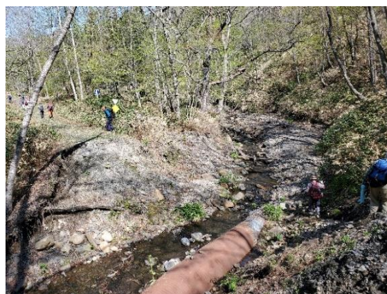
沢筋は大きく削られている
