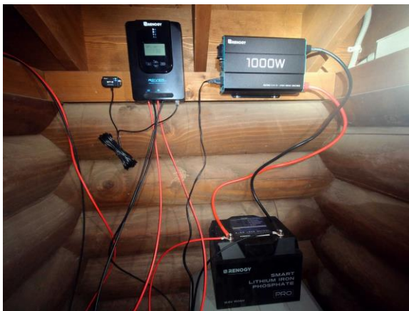
チャージコントローラー、バッテリー等設置
