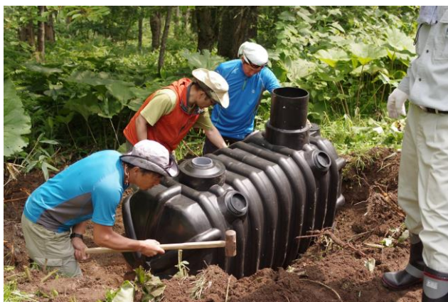
液体貯留タンク
