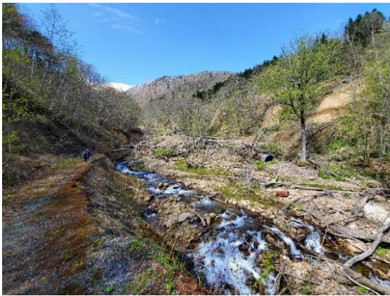
大規模に崩壊した場所
