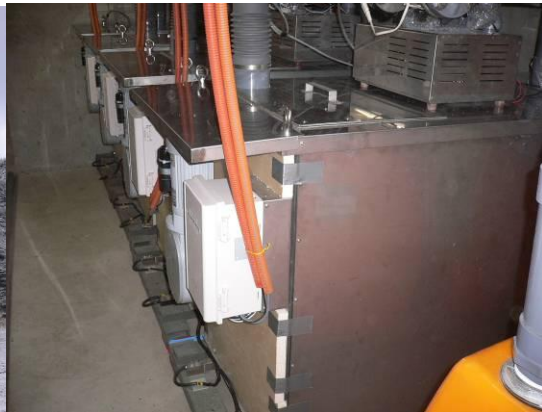
ピット内のバイオR-21
