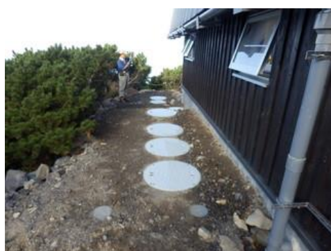
羊蹄山土壌処理・マンホール群
