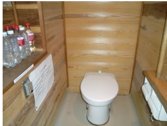
バイオトイレの洋式便器
