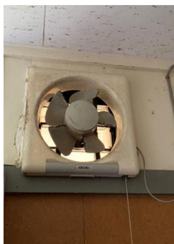
トイレルーム上部壁の換気扇
