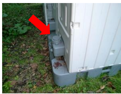
簡易水洗の水注入口
