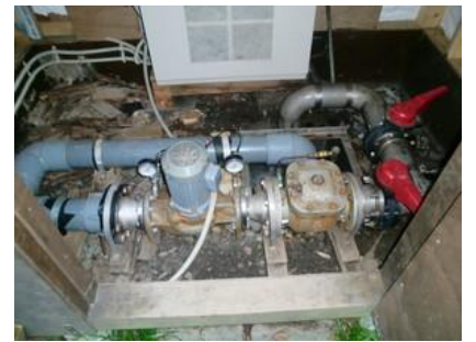
水力発電装置
