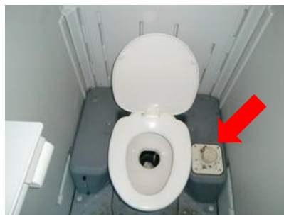
右に簡易水洗の足踏みポンプ
